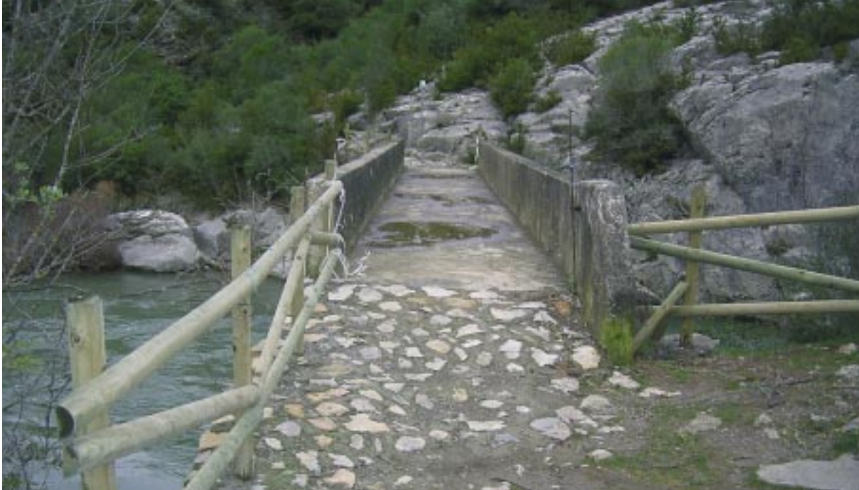
Vista del puente de Usún, a la entrada de la Reserva Natural de la Foz de Arbayún, objeto de consolidación y mejoras en la seguridad de los visitantes.
